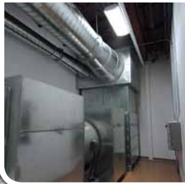
Noise Control Fan Room
